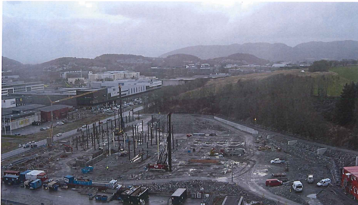
Januar 2017: Murer langs jordbruksvei og fundament for transportbånd er ferdig. Boring av stålkjernepeler for mottakshall er ferdig. Betongarbeid er påbegynt for administrasjonsdel og deler av sorteringshall.
