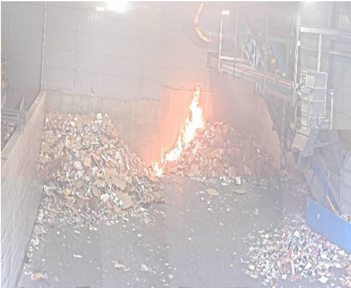
Figur 3-3. Kl. 09:33 strakk flammene seg opp til over betongveggen. Det er kun den nederste delen av veggen som var i betong, den øvre delen var i stål. Bildet er sammensatt av flere bilder og hentet fra IR-kamera montert på vannkanonen.
