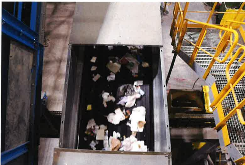
Bildet viser testing av anlegget
